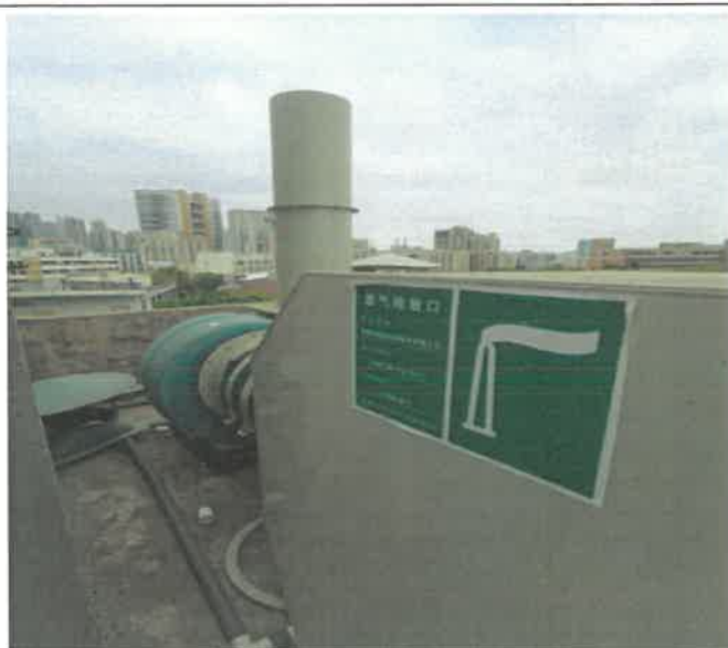
3F 无机废气 P3 排气筒 (FQ-0003)
