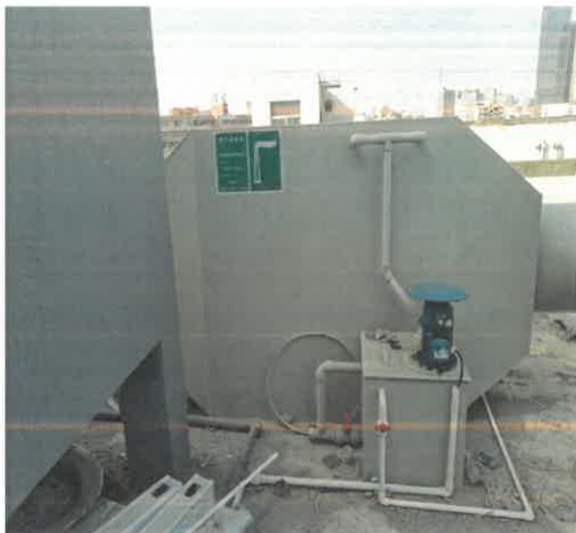
无机废气处理设施
