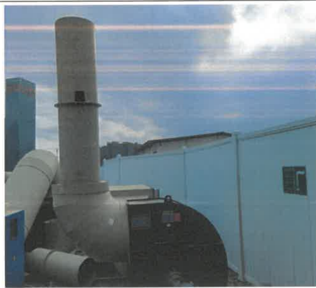
4F 有机废气 P2 排气筒 (FQ-0002)
