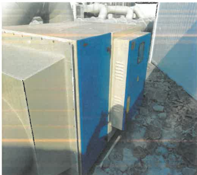
有机废气处理设施
