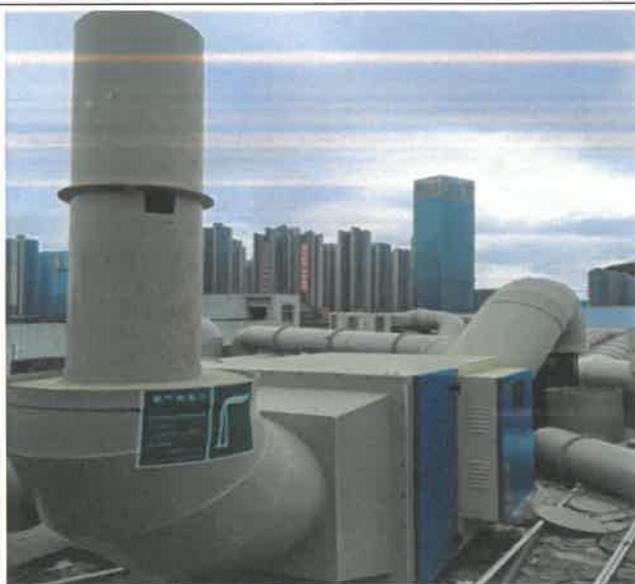
3F 有机废气 P1 排气筒 (FQ-0001)
