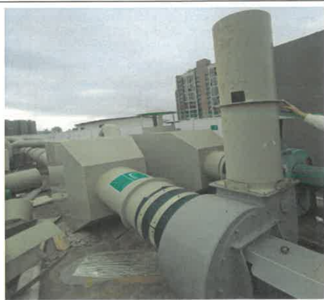
4F 无机废气 P4 排气筒 (FQ-0004)
