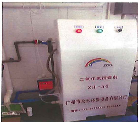
废水处理设施
